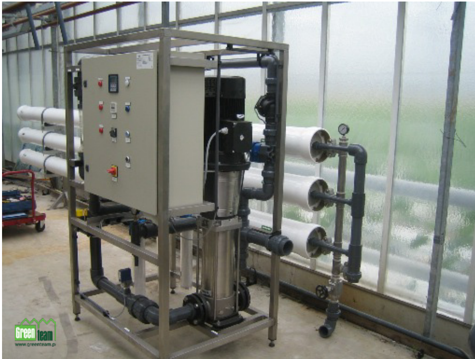
Système d'osmose inverse. Efficacité de 360 m 3 par jour.
